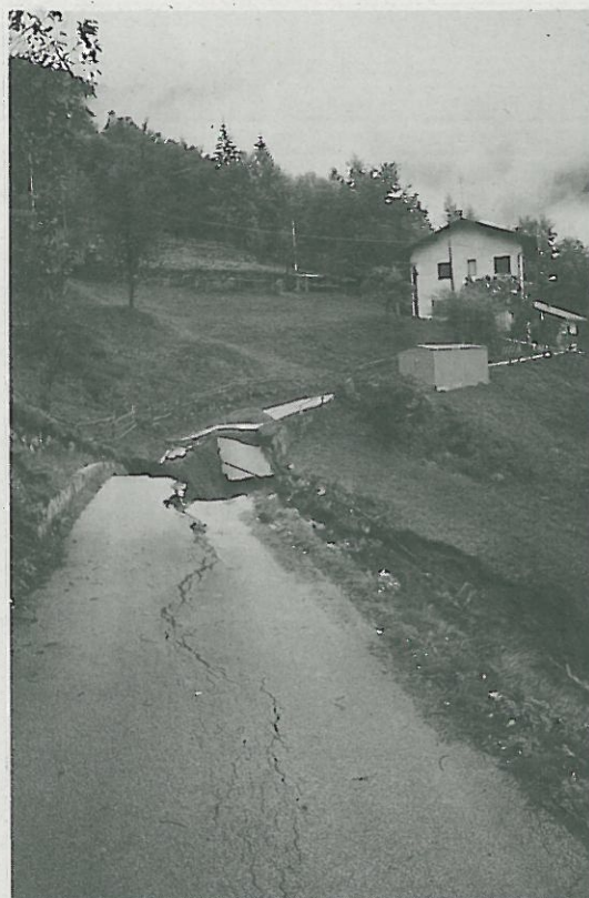
Smottamento strada in loc. "Moretti".
