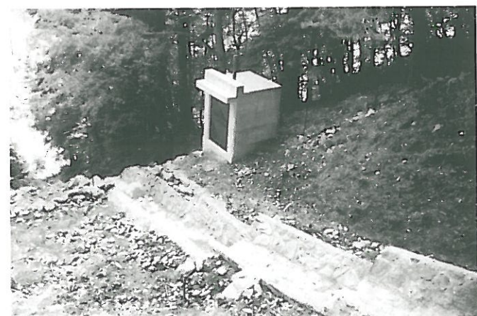
Manufatti della sorgente "Crozi Grandi" dell'acquedotto comunale
